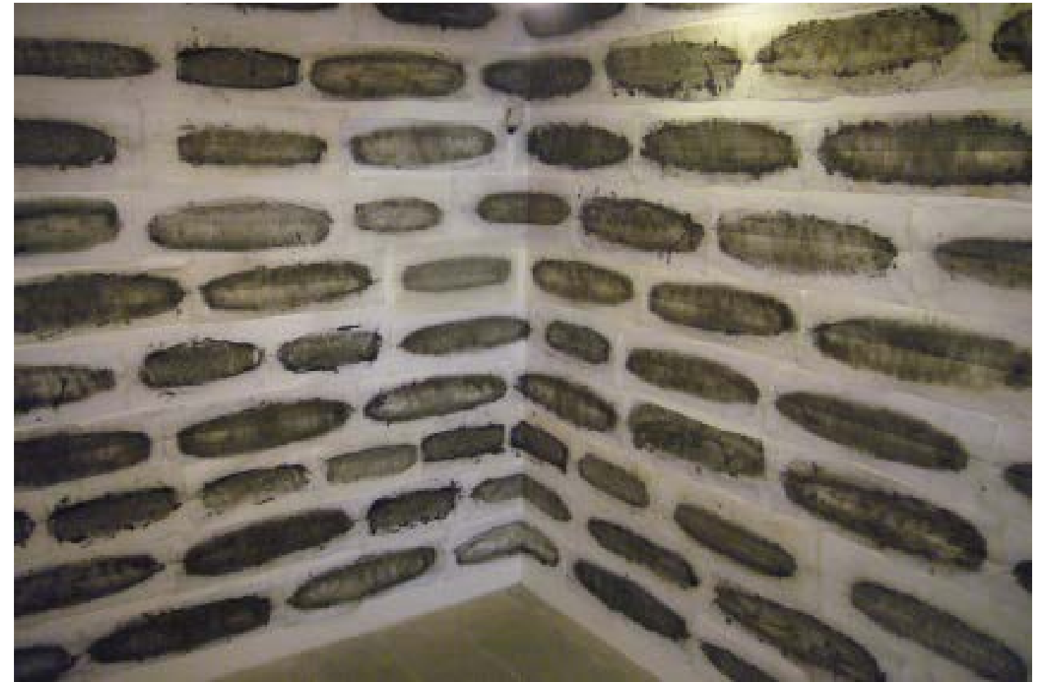
Imagen 2. Detalle instalación. Archivo propio.
